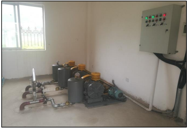
风机设备现状
