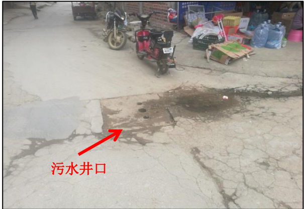
解放路与西北街交汇处污水井口现状
