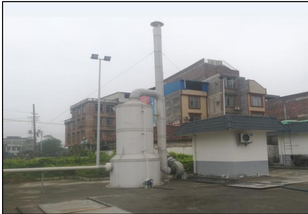
塔式生物除臭装置现状
